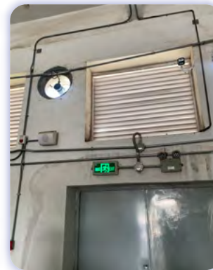
▲ 緊急出口與通風裝置
