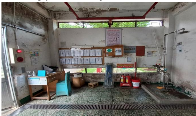
Nội quy và Hệ thống PCCC, rãnh thu gom tại Kho CP2a
